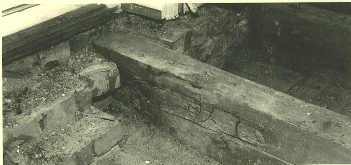
Exempel på golvbjälkar som angripits av brunröta
