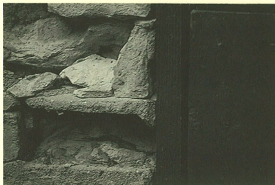
Frostskadat tegel. Fogen av cement håller medan teglet fryser sönder.
